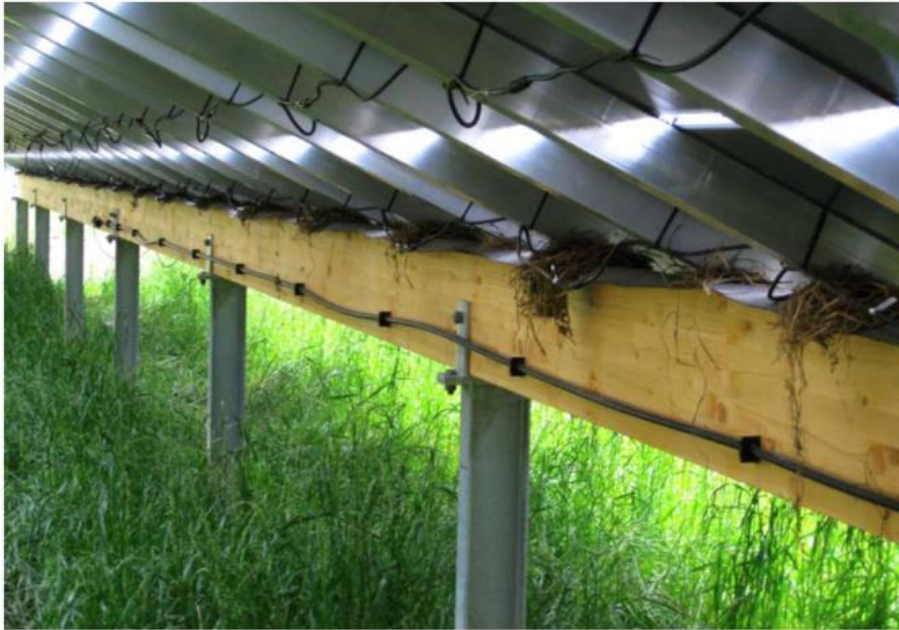
Ilustración 7 Nidos en los soportes de los módulos fotovoltaicos
