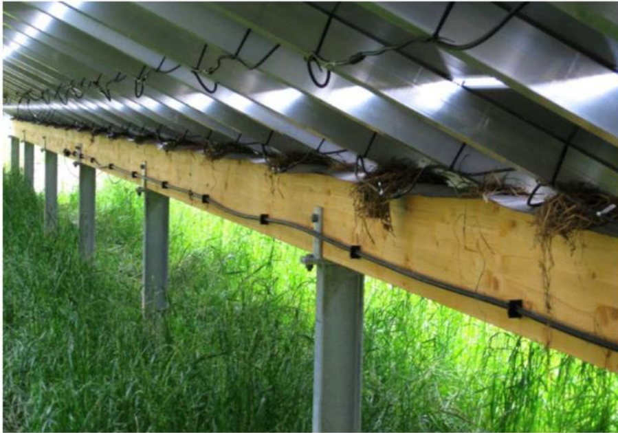
Ilustración 6 Nidos en los soportes de los módulos fotovoltaicos
