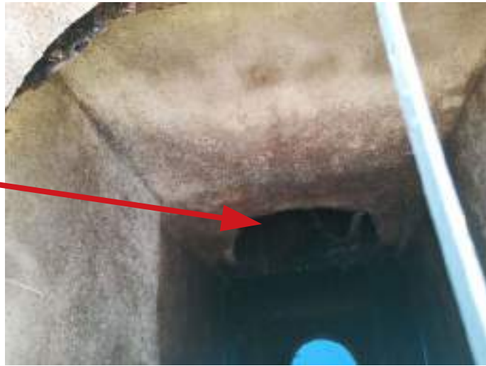
FOTO 5. ARQUETA DE SALIDA DEL COLECTOR DE AGUAS DEPURADAS DE LA EDAR HACIA EL MAR. DIÁMETRO DEL COLECTOR DN = 315 MM.
