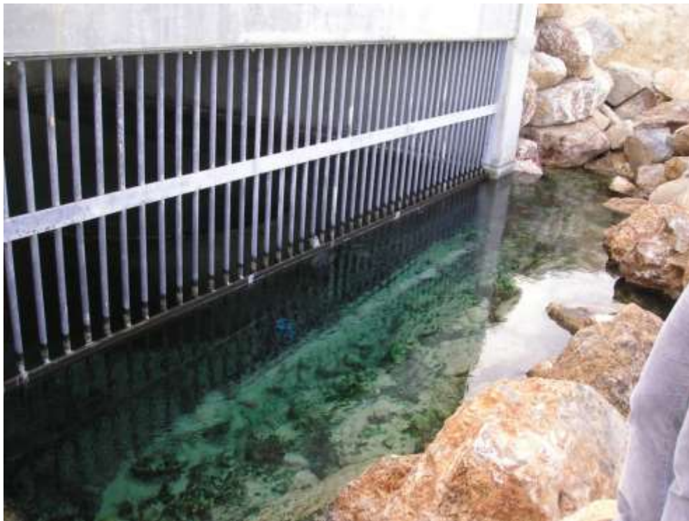
Figura 10: Vertido de la IDAM de Alicante antes de la introducción de la dilución previa
