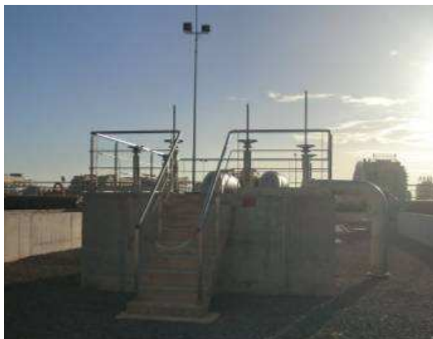
Arqueta de reparto a los dos reactores biológicos
