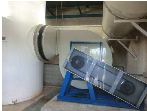
Equipos de desodorización
