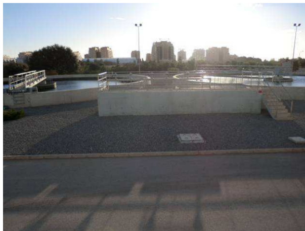
Arqueta de reparto a decantadores secundarios
