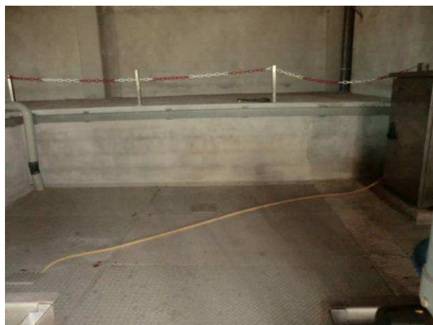
Arqueta de entrada (ubicada dentro del edificio de pretratamiento)
