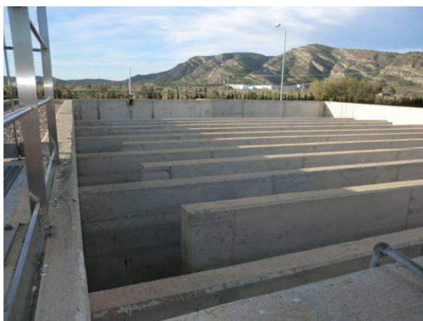
Laberinto de cloración (actualmente no se usa)
