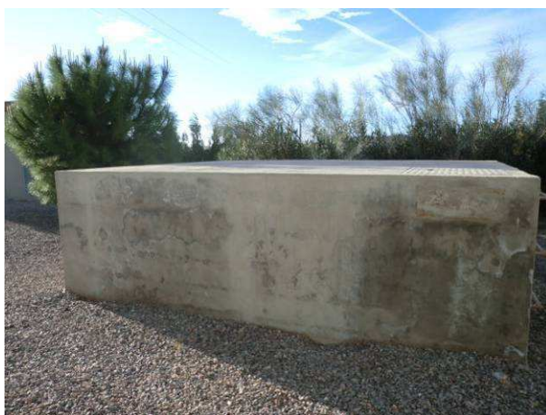
Arqueta general de llegada (ubicada junto al edificio de pretratamiento)
