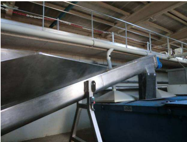
Concentrador de grasas y flotantes
