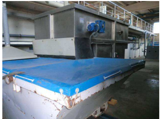
Clasificador-lavador y contenedor de arenas
