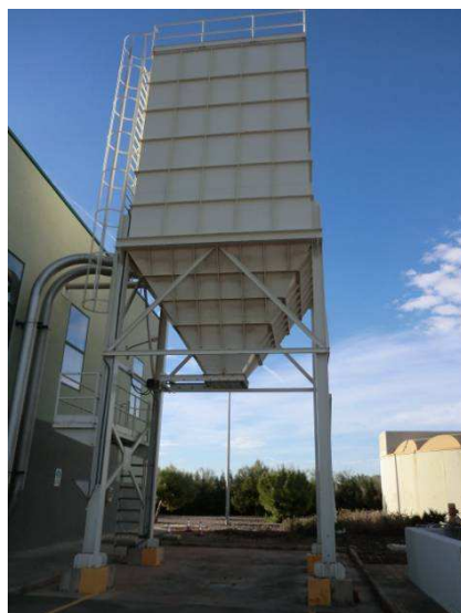
Tolva de almacenamiento de fango
