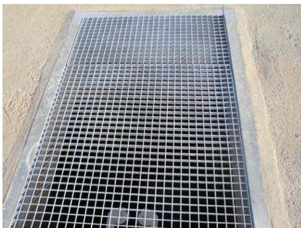
Estación de bombeo del emisario submarino
