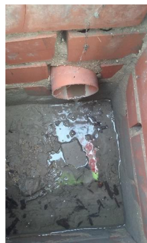
Figura 10. Interior arqueta de toma de muestras
