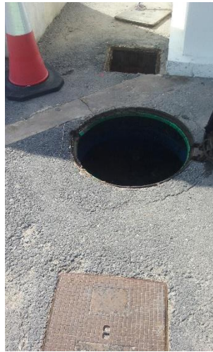
Figura 7. Ubicación separador de hidrocarburos
