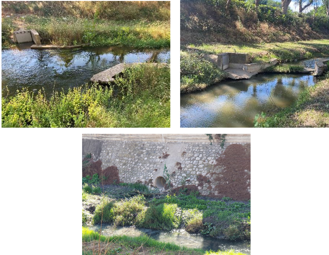
Figura 9. Aliviaderos en el Bco. de Picassent a la altura de Beniparrell.
