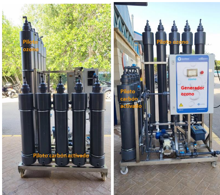
Figura 3. Plantes pilot i generador d'ozó muntades sobre estructura (elaboració pròpia)
