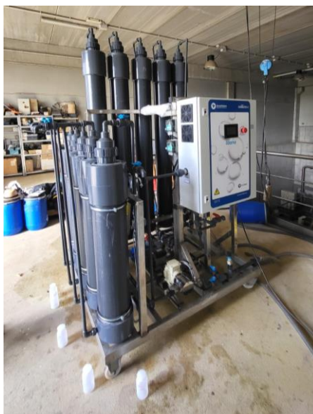
Figura 4. Plantes pilot instal·lades en la EDAR Alicantí Nord (elaboració pròpia)
