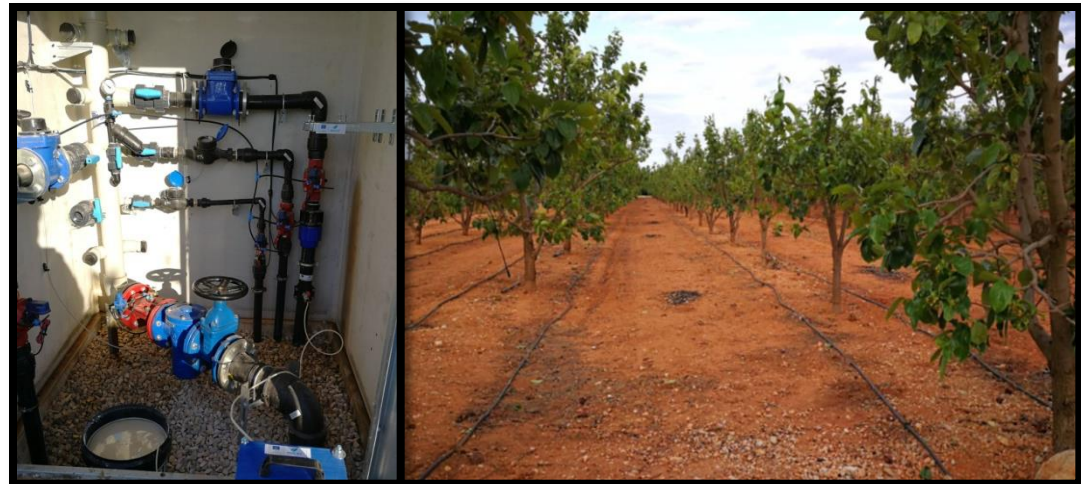
Tratamientos vía riego localizado (sistema IRRILIFE)
