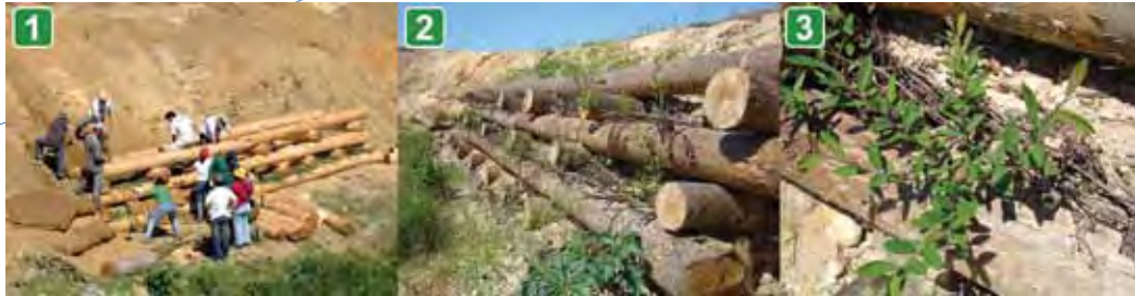
Figura 5.1.24 Construcción del entramado de madera doble para contener el talud (1), cara frontal del entramado (2) brotación de las estacas de sauce del entramado (3) (fotos: Regina Carriço, 1, y André Fabião, 2 y 3).
