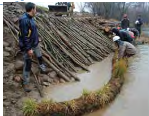
Figura 4.5.4.3 Construcción de una estera de ramaje con estacas de sauce y colocación de un biorrollo vegetado en la base. Río Ter en Salt, Girona) (foto: Joaquim Bosch).
