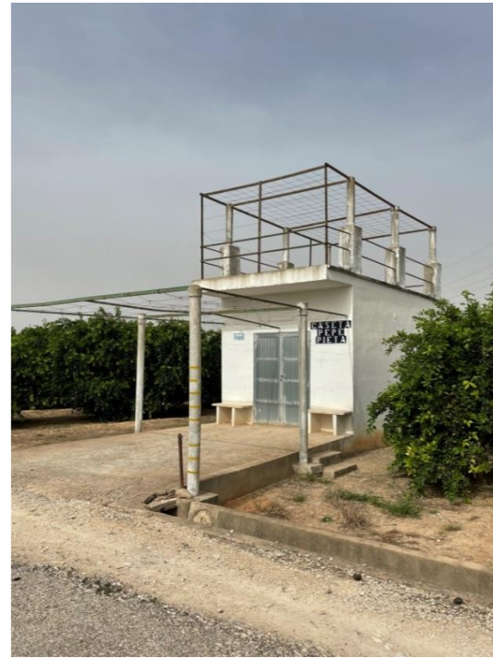
Foto 40. Edificación afectada parcialmente en parcela 82 del poligon 8 de Carcaixent.
