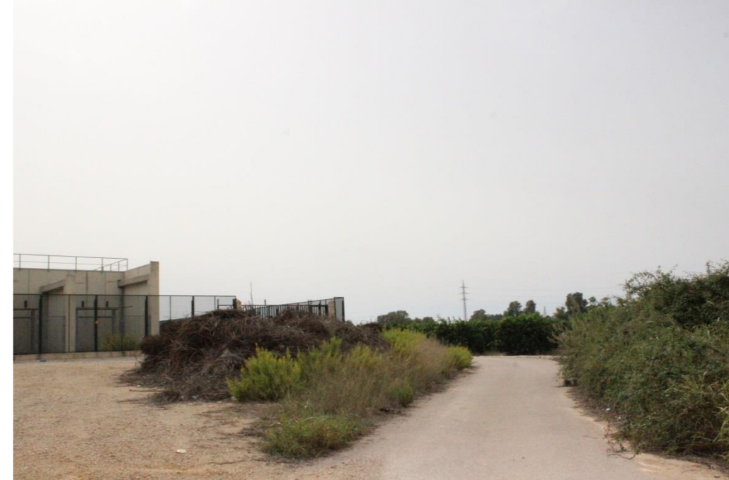
Foto 27.- Instalaciones eléctricas junto al ff, parcela 268.Pol.32 de Alzira.
