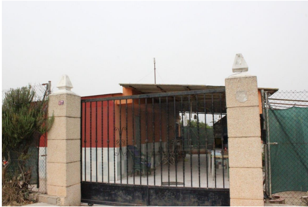
Foto 21. Edificación afectada en la parcela 204 del polígono 32 de Alzira.
