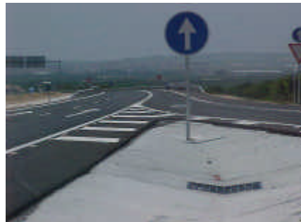
Arqueta embebida en una cuneta franqueable
