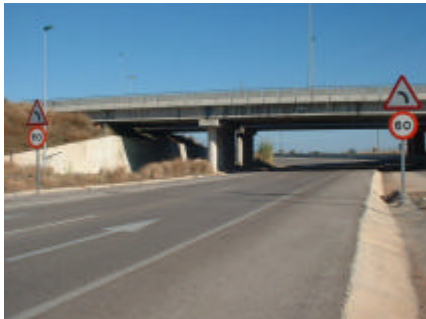
Pilas de puente sin proteger
