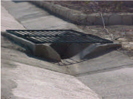
La cuneta es franqueable, pero la arqueta no.
