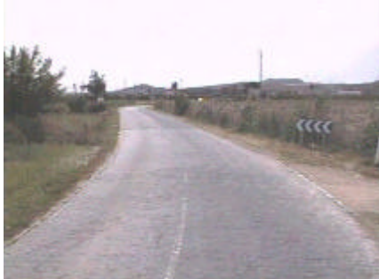
Marcas viales de borde inexistentes, y las de eje borradas
