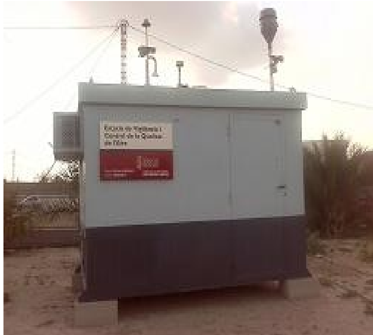
Foto: Estación de ELX-PARC DE BOMBERS
