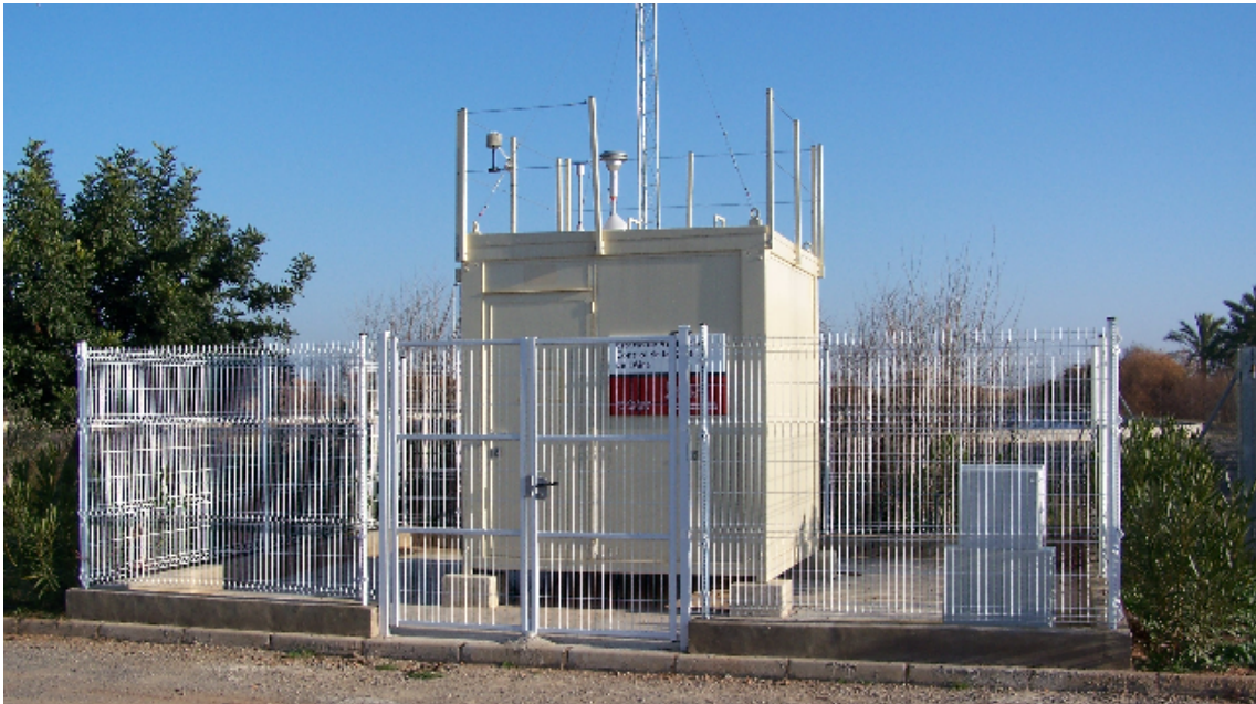
Foto: Estación de SAGUNT-CEA
