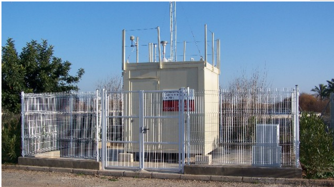
Foto: Estación de SAGUNT-CEA
