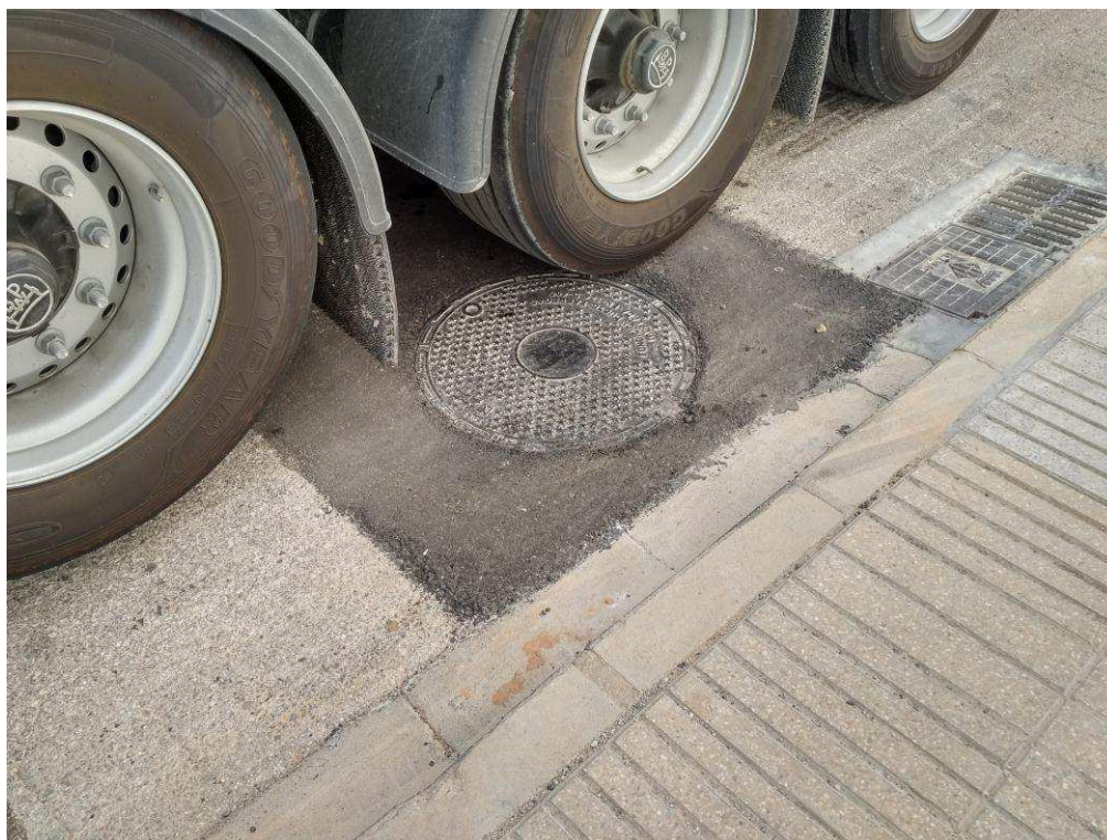
Foto 11: Red de alcantarillado e instalaciones
