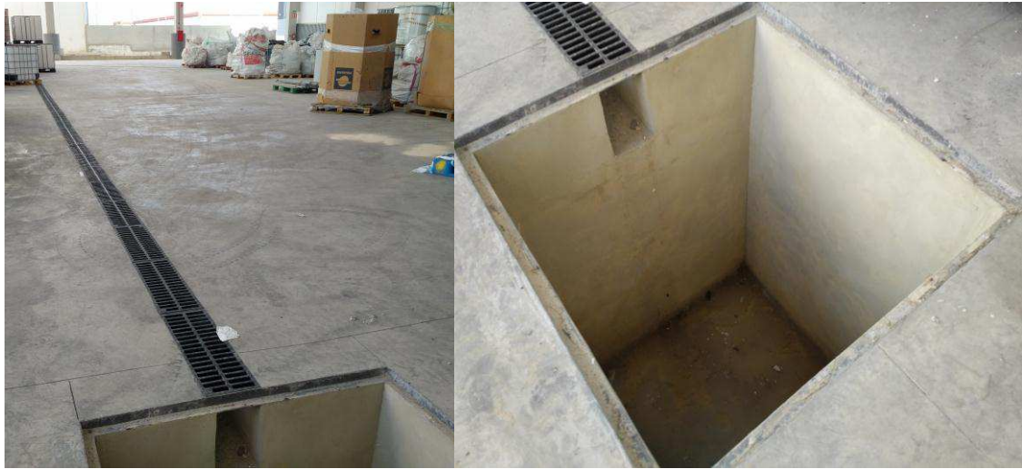
Fotos 7 y 8: Sistema arqueta
