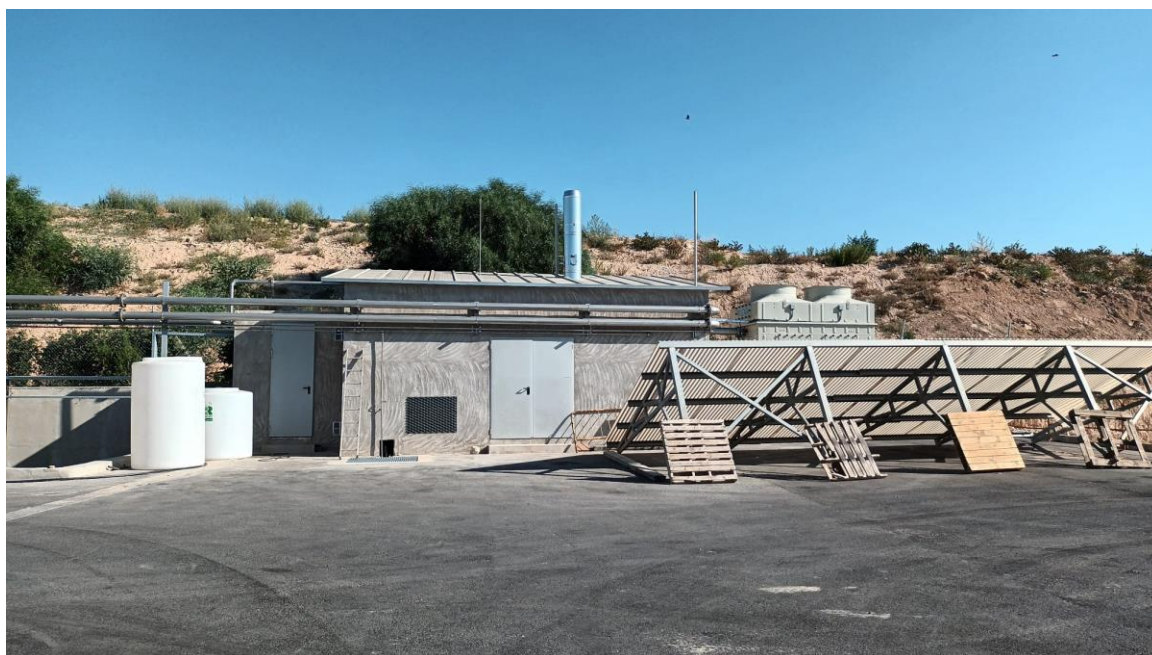
Generador de vapor y torre de refrigeración.
