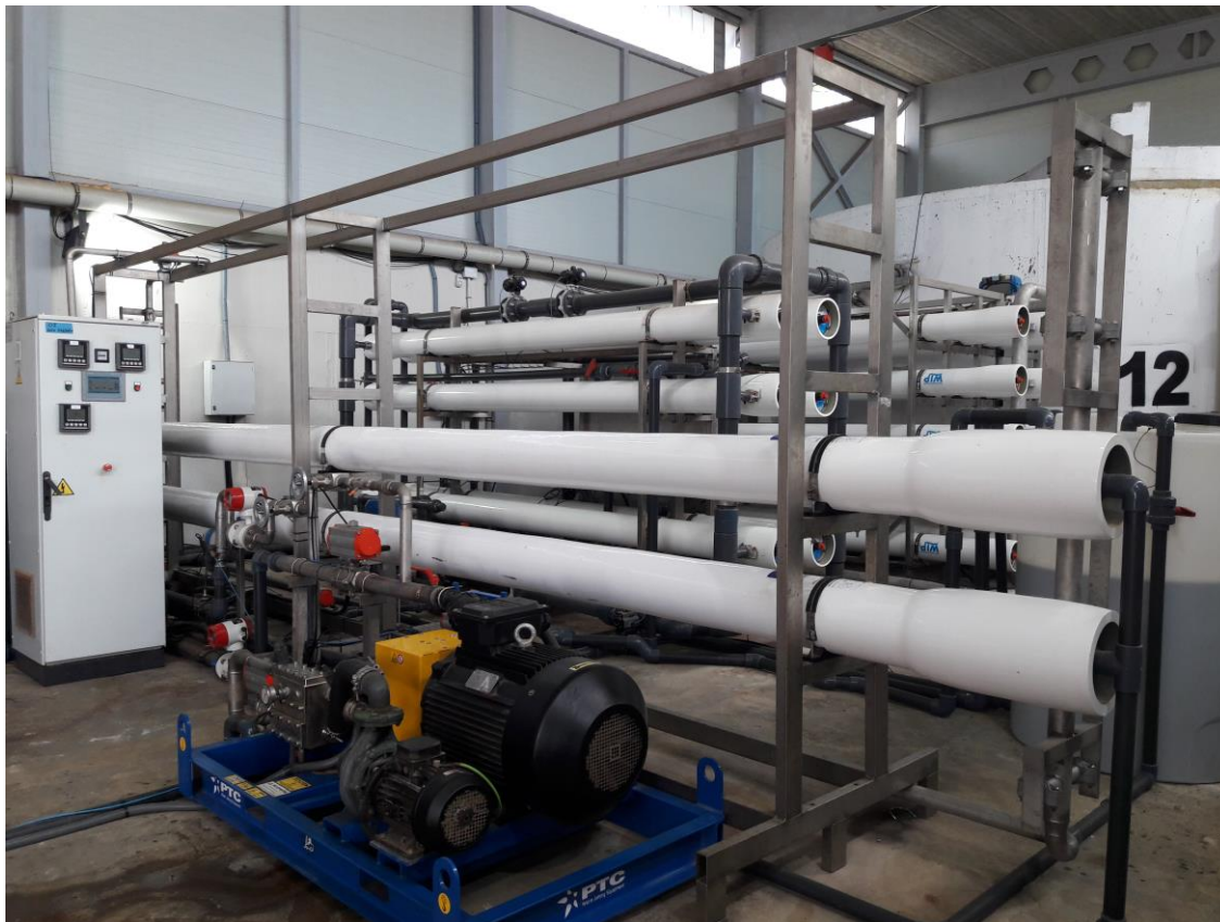
Módulo de ósmosis inversa con espacio en la parte superior para ampliar la línea.
