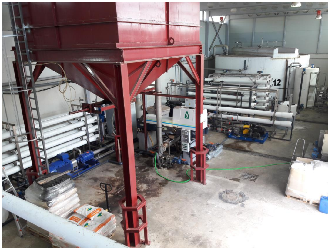
Silo de fangos deshidratados, decantadora centrífuga y líneas de ósmosis actuales, por detrás ultrafiltración y al fondo, depósito 12 o depósito pulmón para la alimentación de la ultrafiltración.
