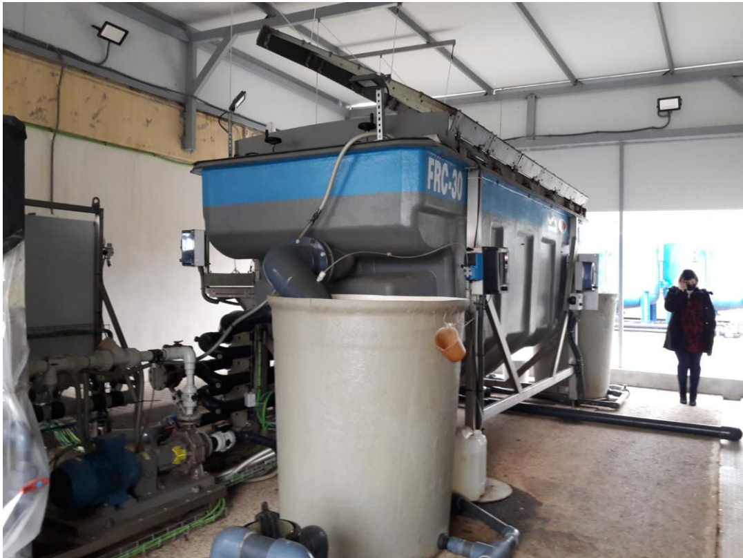
Unidad de flotación DAF
