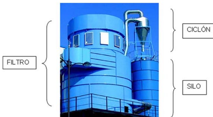
Ciclofiltro: Instalación para tratamiento de polvo de madera. Fotografía cortesía de COTINO.
