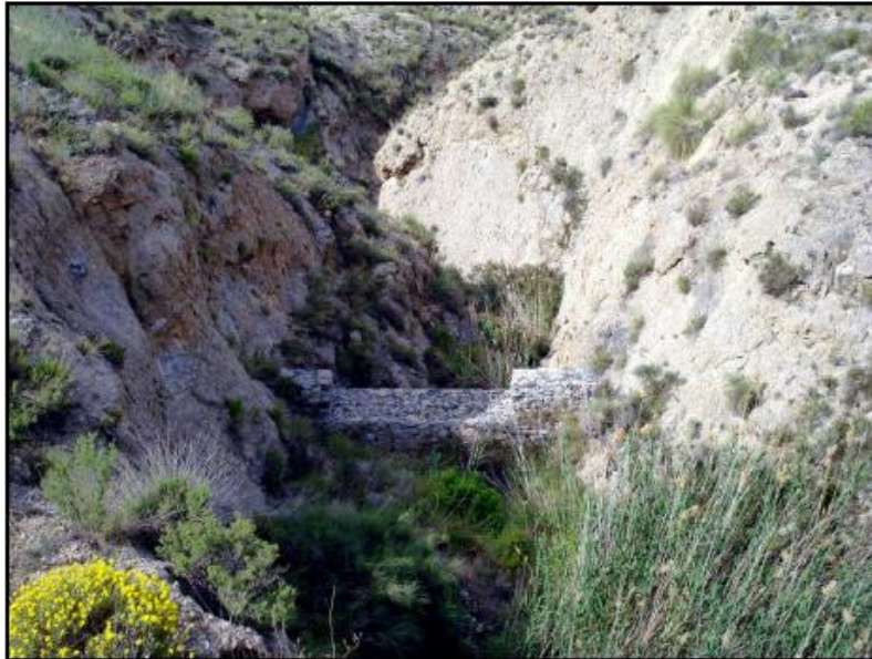
Subcuenca 8 – Vega Baja, T.M. de Albaterra, Barranco de las Ventanas - Dique 7, vista posterior.
