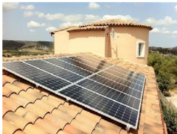
Figura 16. Instal·lació Solar Fotovoltaica en Vivienda Aislada. Fuente: Solar Montraí Instalaciones Solares .
