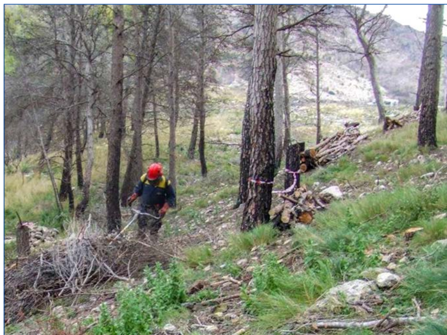
Imagen 3. Trabajos de tala, desbroce y construcción de fajinas en terreno incendiado en la Microrreserva de Flora Mola de Serelles (Alcoi, Alicante).
