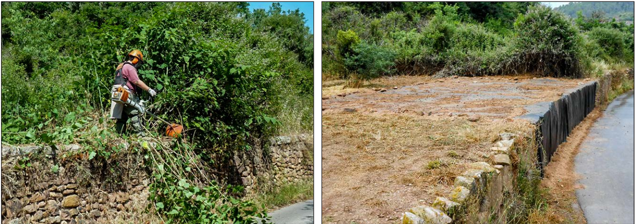
Figura 7. Desbroce de la viña del Tíbet previo a la colocación de coberturas (PN Espadán).
