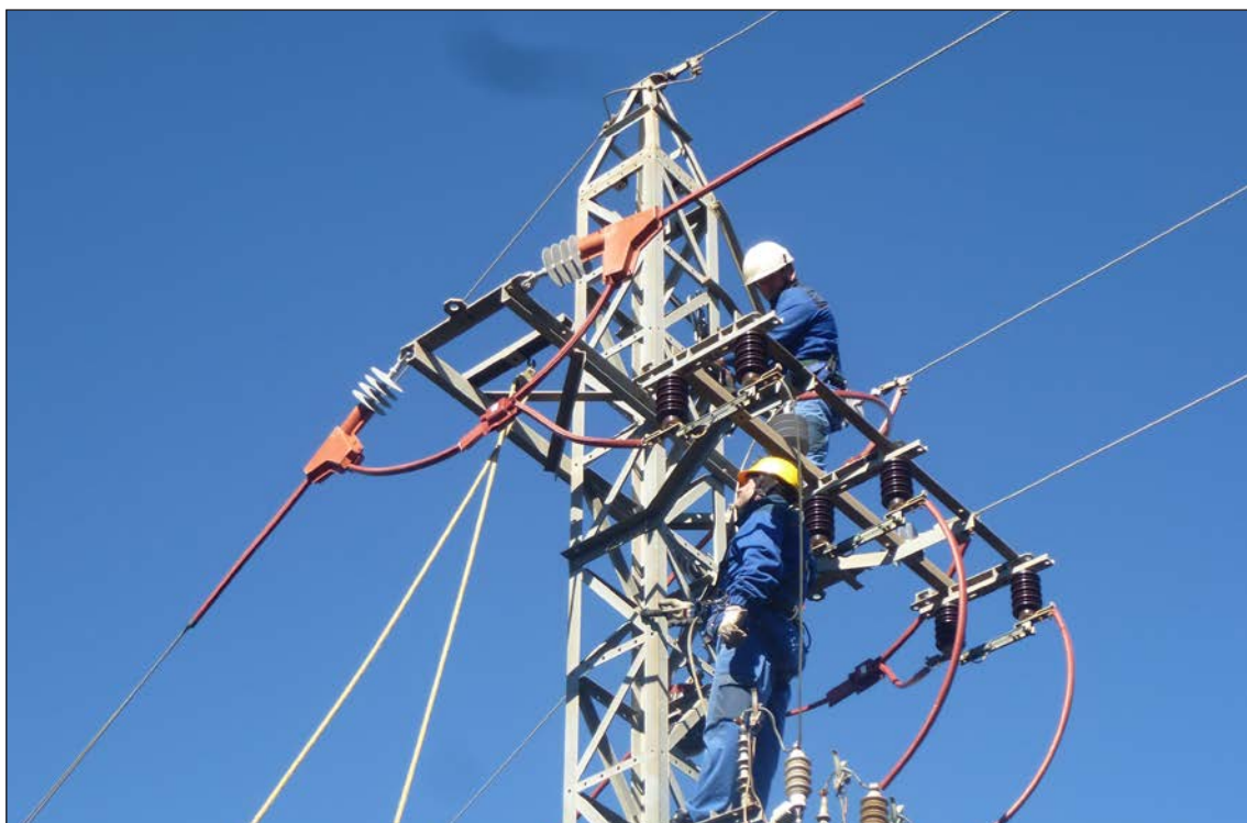
Trabajos de corrección en línea de la Generalitat de Mondúver. Autor: Elecnor.
