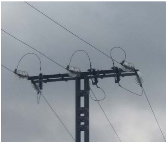
MUY ALTA. Apoyo de amarre con puentes por encima de la cruceta.
