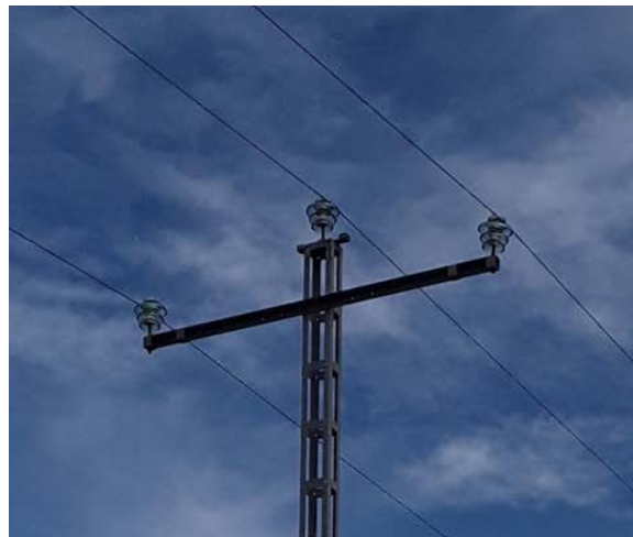
ALTA. Apoyos de alineación con aisladores rígidos.
