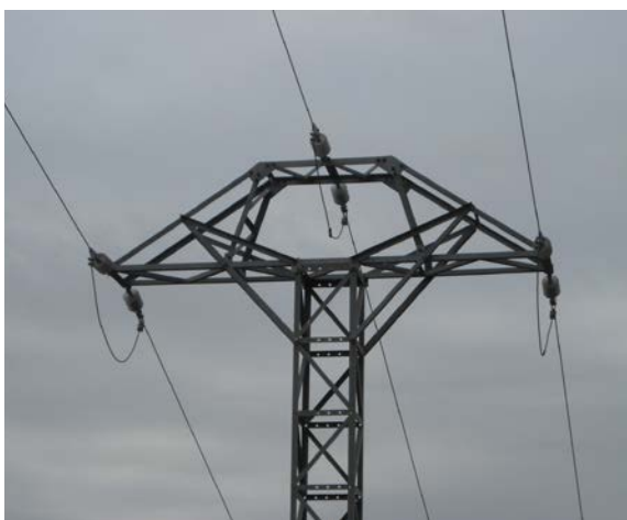
MEDIA. Apoyos de amarre con puente central por debajo de los aisladores próximo a zona donde se pueden posar las aves.
