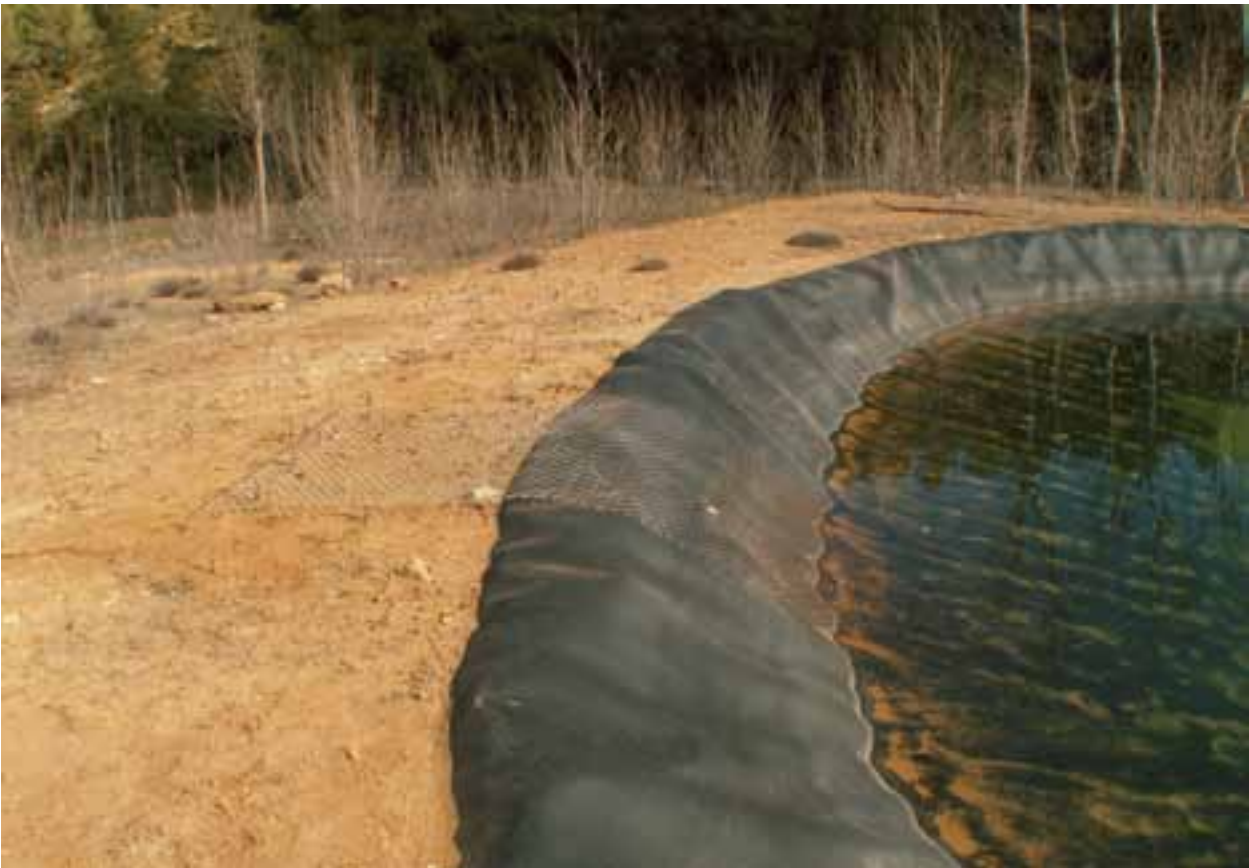
La instalación de una malla metálica es una solución de emergencia para facilitar el escape de animales que hayan caído en la balsa.
