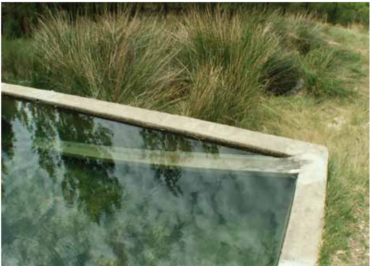
La solución más sencilla para instalar rampas en balsas consta de una o varias vigas. En el ejemplo, Balsa de la Boquera del Tormillo (Utiel).
