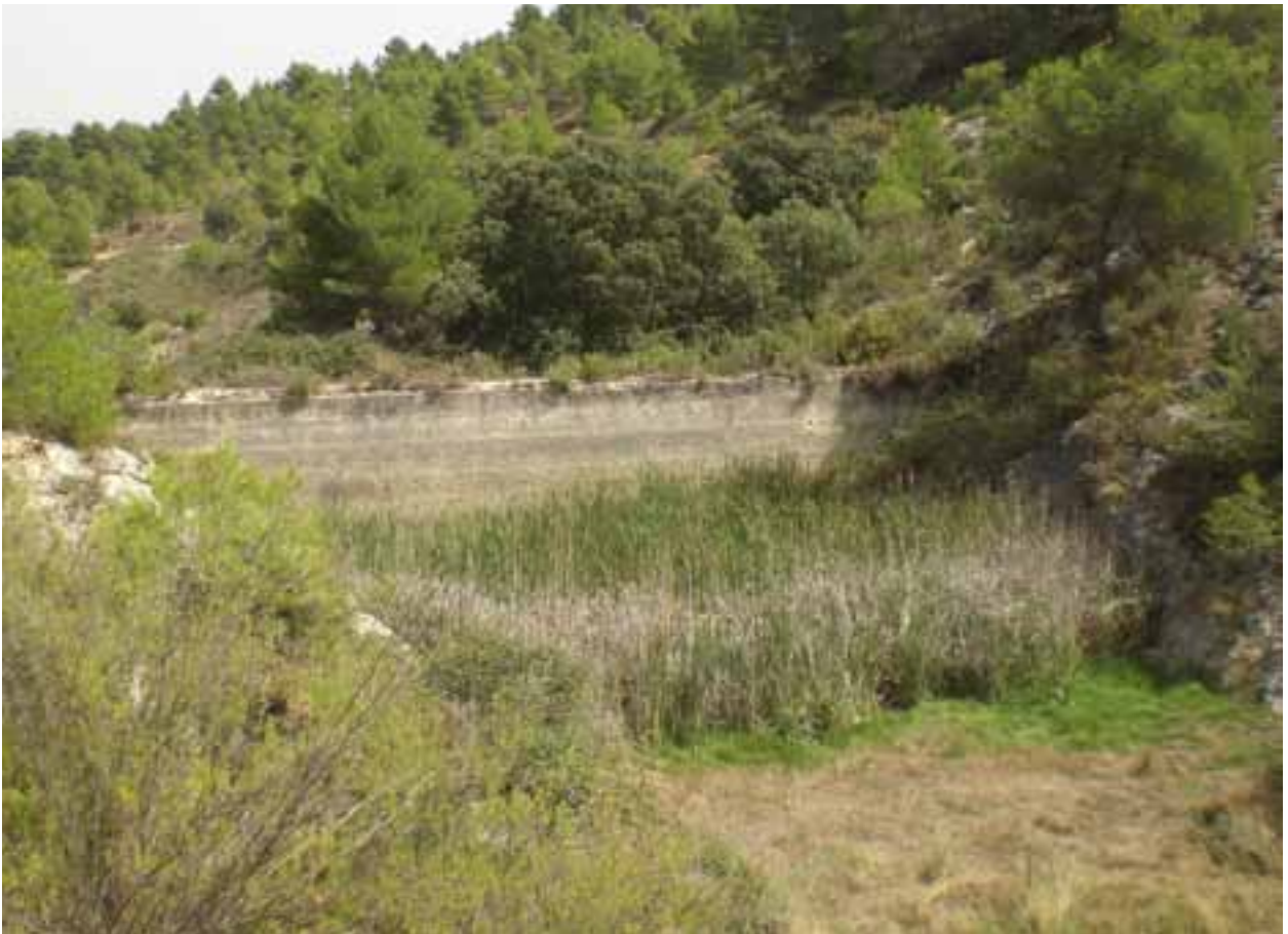
El Pantanet del Mas del Safraner (Alcoi), una pequeña presa que había perdido su capacidad de retener el agua debido a unas grietas en el azud.
