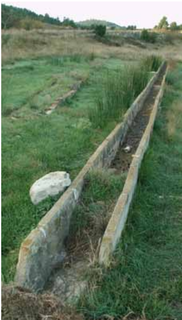
Manantial de la Canaleta (Higueruelas). La pérdida de uso ha ocasionado su abandono y la rotura del abrevadero.
